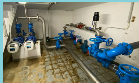
Das Pumpwerk Launsdorf war im Sommer 2022 Drehscheibe für die gerechte Aufteilung der reduzierten Wassermengen
